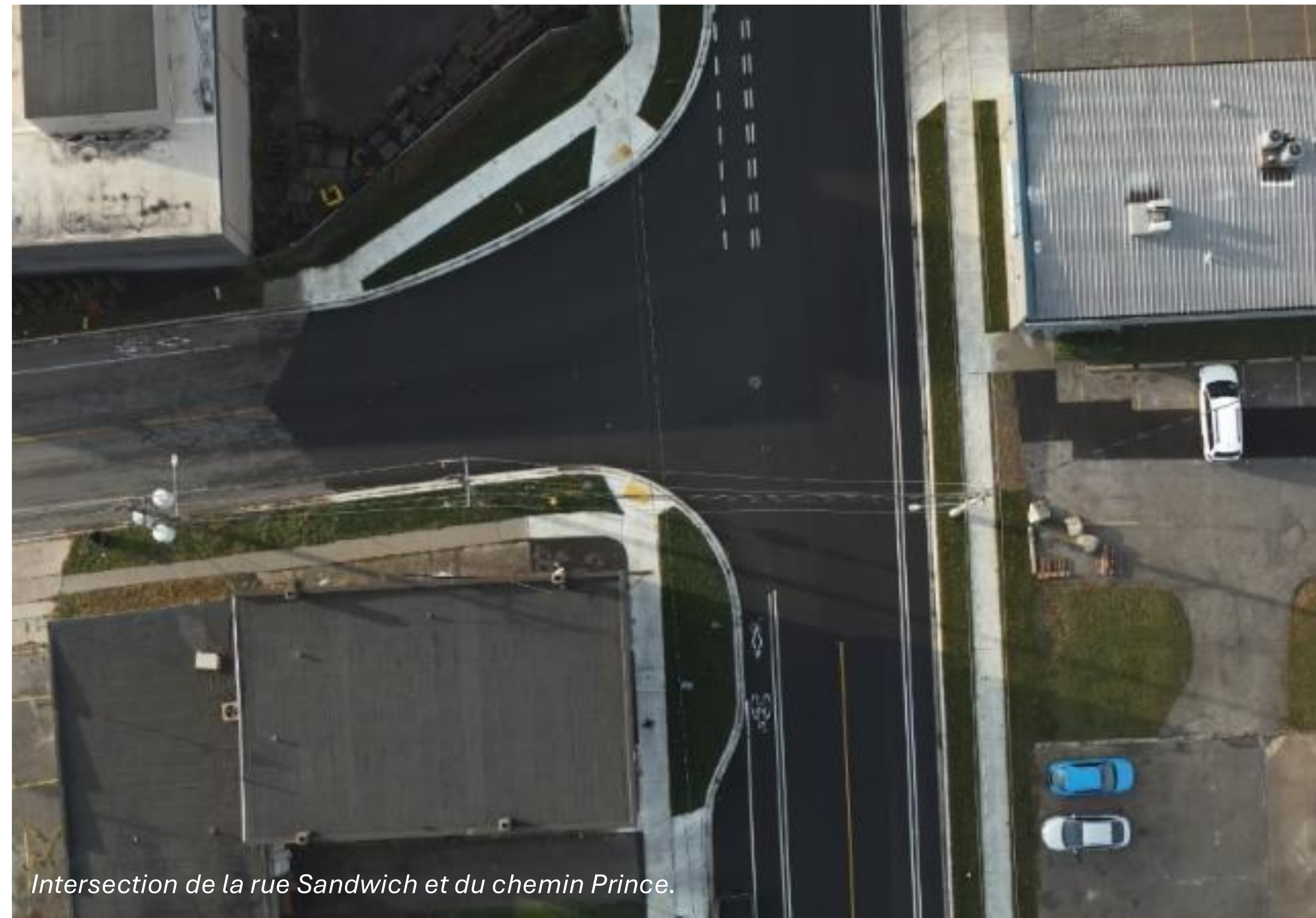
Progrès de la reconstruction de la rue Sandwich face à l'est de la rue Mill.
